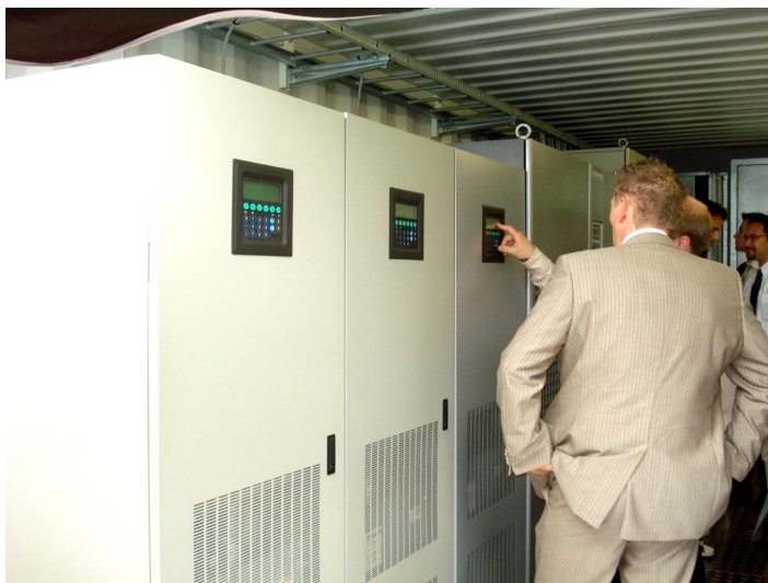
Drie VSS+DC units in parallel, UPS systemen en een elektrogeengroep, samen in mobiele container voor maximale autonomie en flexibiliteit
